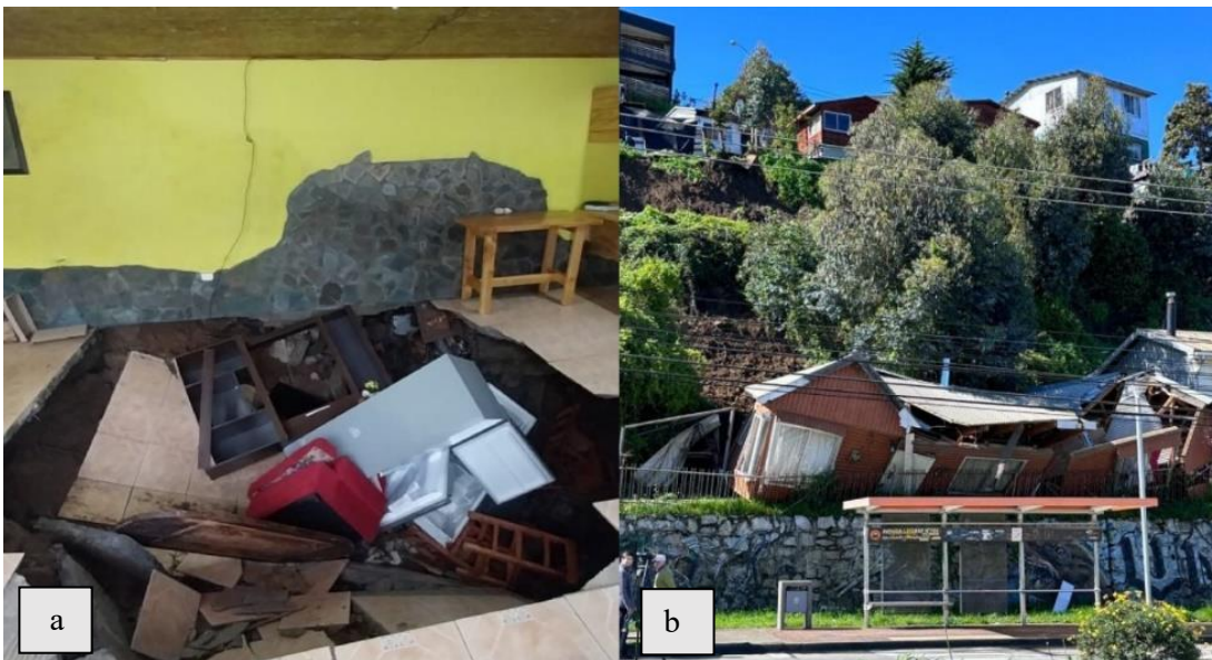
Figura 1: Daño estructurales de viviendas en Tomé: a. Socavón al interior de una casa; b. Colapso de ladera y vivienda. (Modificado de Espinoza, 2023).
