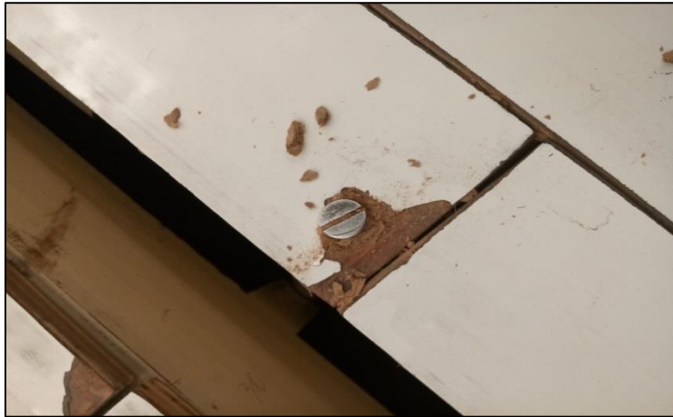
Figura: 3.11 Deterioro mesas grading
