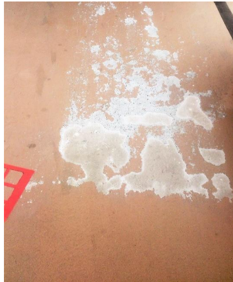
Figura 5: Recubrimiento defectuoso en losa.
