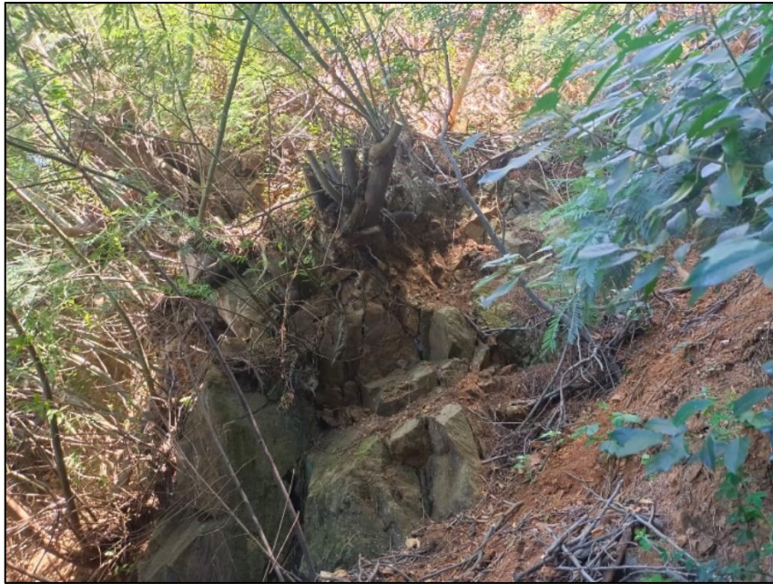
Figura 15: Roca diaclasada por vegetación, Sector Baños Escuela F - 490. Elaboración propia.
