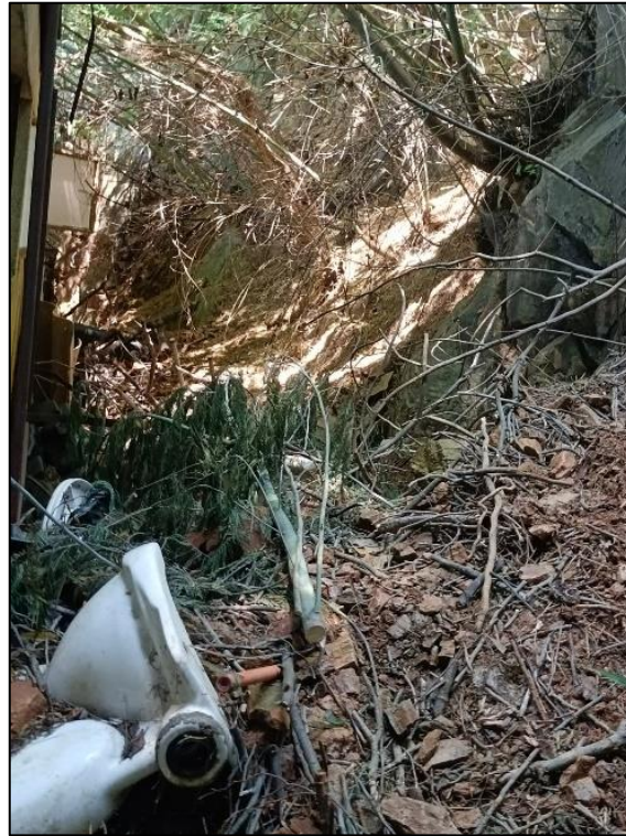
Figura 17: Acumulación del material caído del talud Sector Baños. Escuela Básica F - 490. Elaboración propia.
