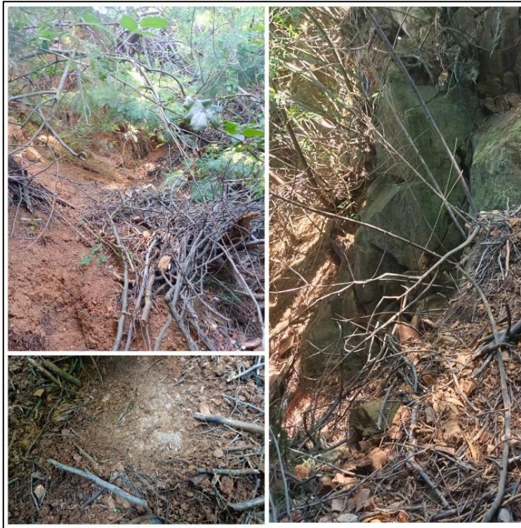
Figura 13: Meteorización macizo rocoso Sector Baños, Escuela Básica F - 490. Elaboración propia.
