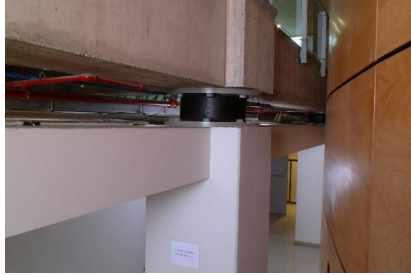
Figura 2. 10: Aisladores sísmicos utilizados en la Clínica San Carlos de Apoquindo (www.SIRVE.cl).
