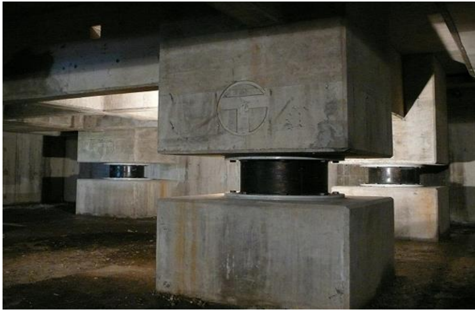
Figura 4. 9: Montaje real de los aisladores sísmicos ( www.sirve.cl ).
