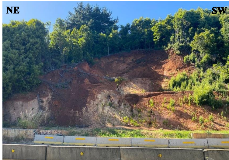
Figura 4: Talud en el área de estudio (diciembre, 2024), con cuatro terrazas. Se observan erosión, grietas y algunas zonas cubiertas por vegetación.
