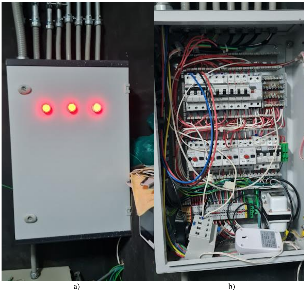
Fig. 43. Tablero TFyA en LSG. a) Vista exterior. b) Vista interior en ensayos eléctricos. Elaboración propia.
