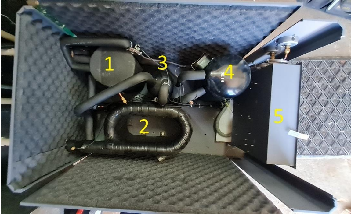
Fig. 9. Interior BCG, 1) Intercambiador calor Gas-estanque acumulador, 2) Intercambiador calor sub suelo-Gas, 3) Descompresor gas, 4) Compresor gas, 5) Panel eléctrico. Elaboración propia.
