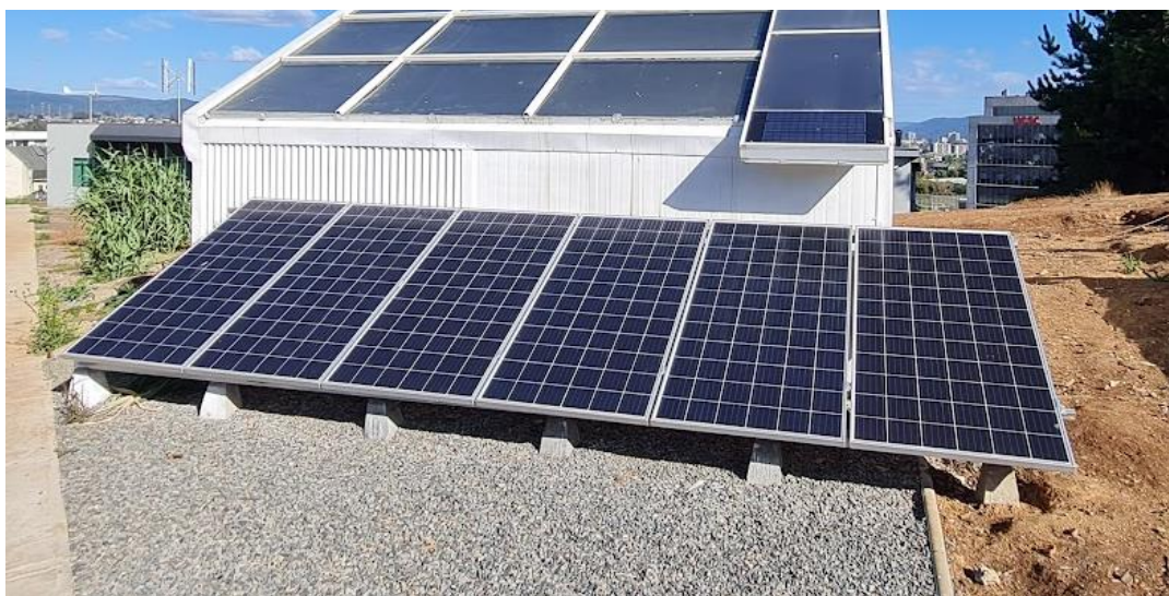
Fig. 34. Paneles fotovoltaicos instalados en el laboratorio de secado Geosolar. Elaboración propia.
