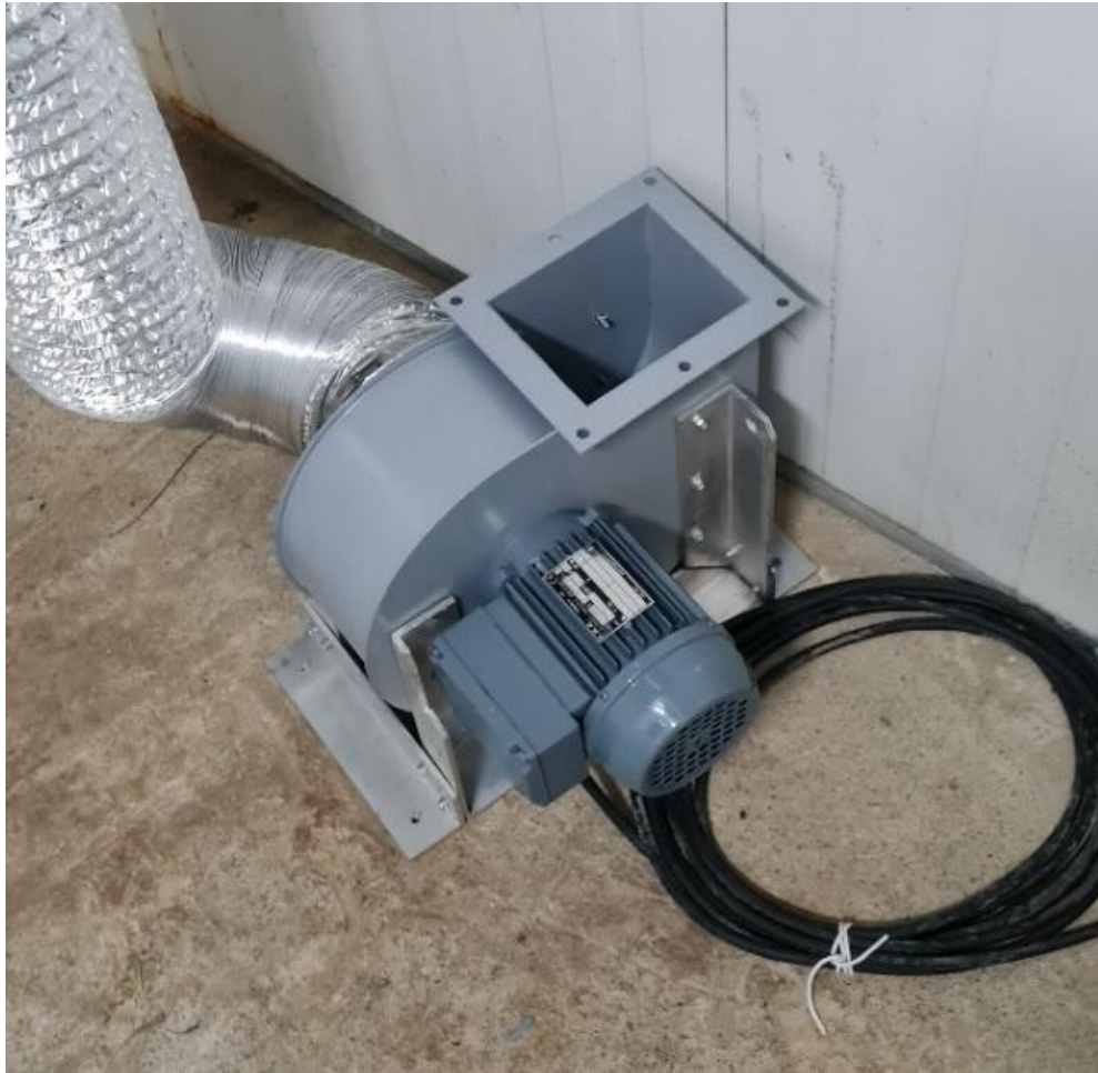
Fig. 22. Ventilador centrífugo aire del sistema techo solar UCSC. Elaboración propia.
