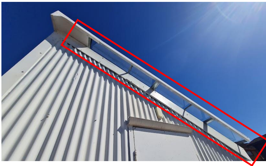
Fig. 21. Entrada del aire a la cámara del aerotérmico señalado con el recuadro rojo. Elaboración propia.
