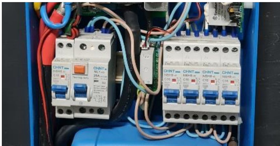
Fig. 29. Distribución y protecciones eléctricas de las cargas AC y red eléctrica a la entrada. Elaboración propia.
