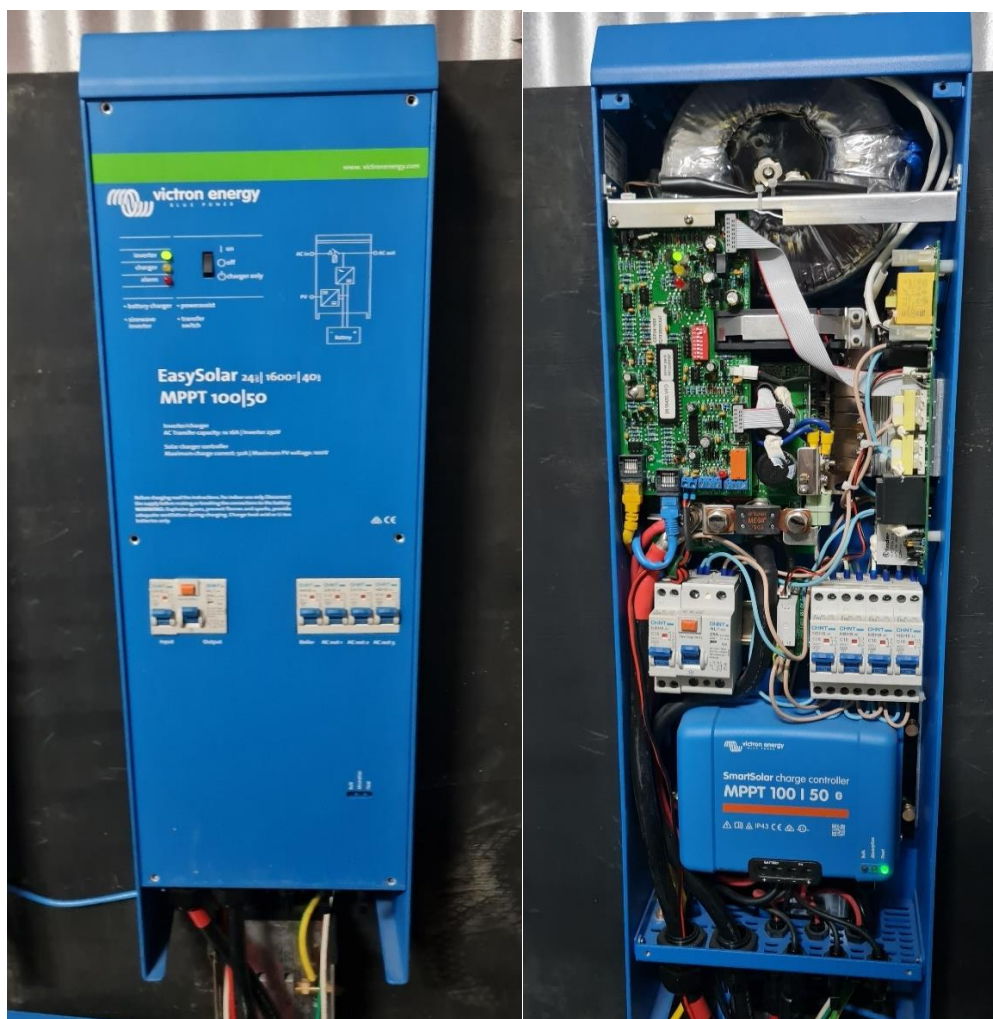
Fig. 27. Inversor Victron Energy modelo EasySolar 24/1600/40 instalados en el LSG. Elaboración propia.
