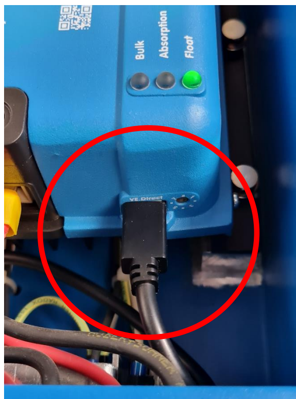
Fig. 57. Cable para datos para enviar información de estado de carga al ColorControl GX. Elaboración propia.
