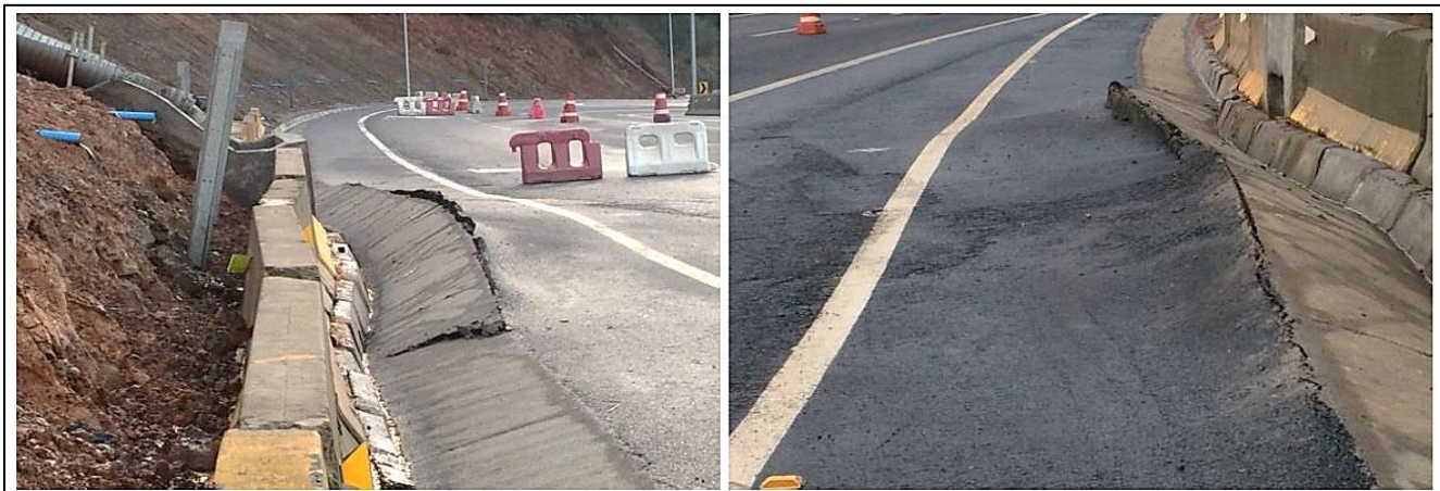
Figura 8: Rotura cuneta, berma y deformaciones a nivel de pista de incorporación (Concesionaria Ruta CH-160 – Evaluación talud dm 40+000 – 40+400; Informe Técnico).
