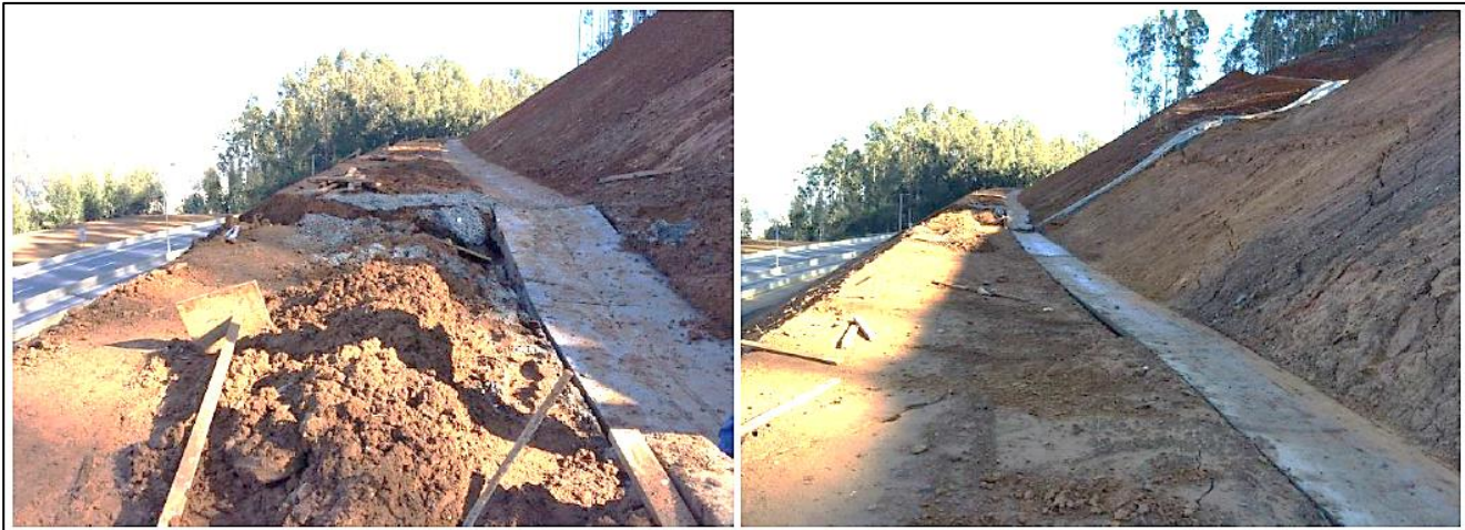
Figura 7: Ruptura badén y deformaciones en terraza primer banco (Concesionaria Ruta CH-160 – Evaluación talud dm 40+000 – 40+400; Informe Técnico).
