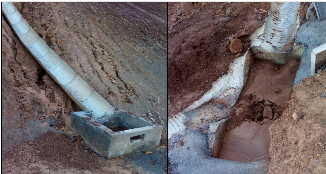
Figura 19: Canales sin conexión con el contrafoso principal (Fotografías tomadas en Mayo 2017).
