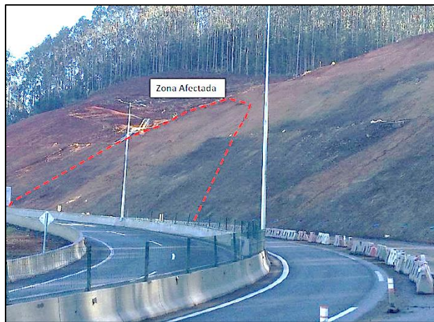
Figura 6: Identificación de zona inestable (Concesionaria Ruta CH-160 – Evaluación talud dm 40+000 – 40+400 Informe Técnico).
