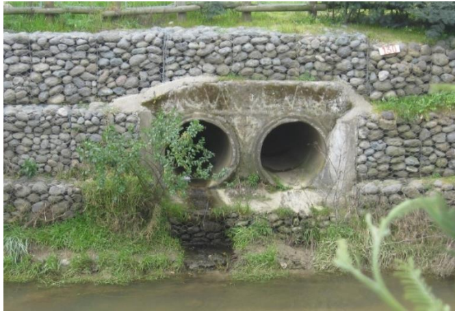
Figura 36. Descargas de agua lluvia. (Fuente: Elaboración propia).
