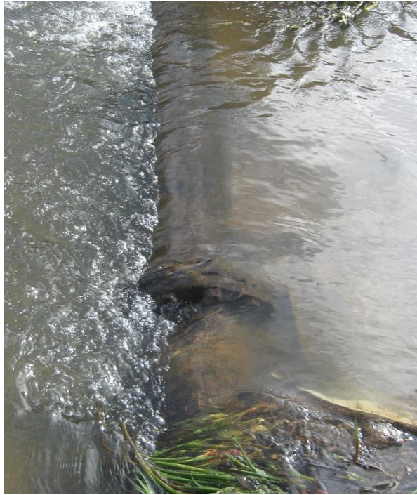
Figura 39. Estado de tubería. (Fuente: Elaboración propia)
