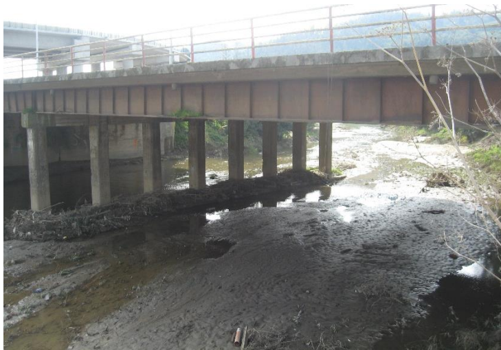
Figura 35. Exceso de sedimento en lado izquierdo de Puente Nonguén. (Fuente: Elaboración propia).
