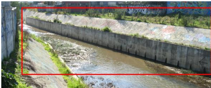
Figura 20. Muro de protección n°3 margen derecho. (Fuente: Elaboración propia).
