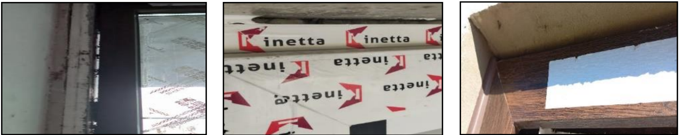
Figura 3. Instalación con errores de sellos. Fuente: Fotos propias.
