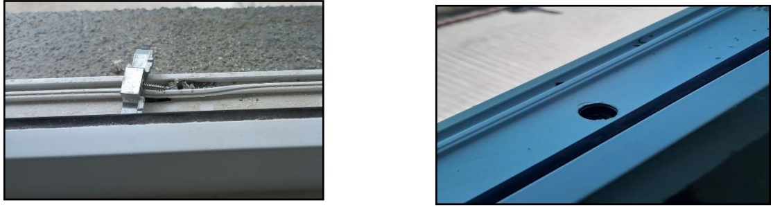
Figura 6. Instalación de accesorios en mal estado. Fuente: Fotos propias
