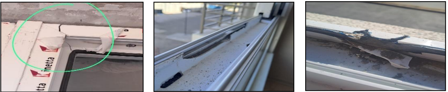
Figura 5. Estructuras quebradas. Fuente: Fotos propias
