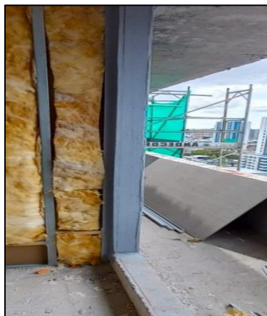
Imagen 2. Vano en condiciones
