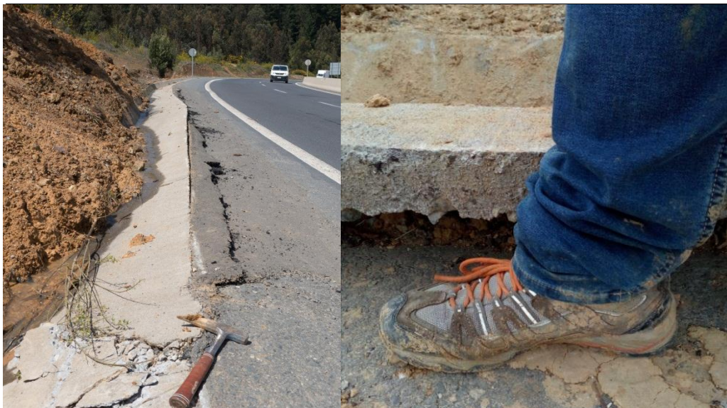
Figura 2: Daño causado sobre la cuneta y la calzada de la Ruta CH-160. Fotografías tomadas en octubre de 2017, antes del último retiro de material.
