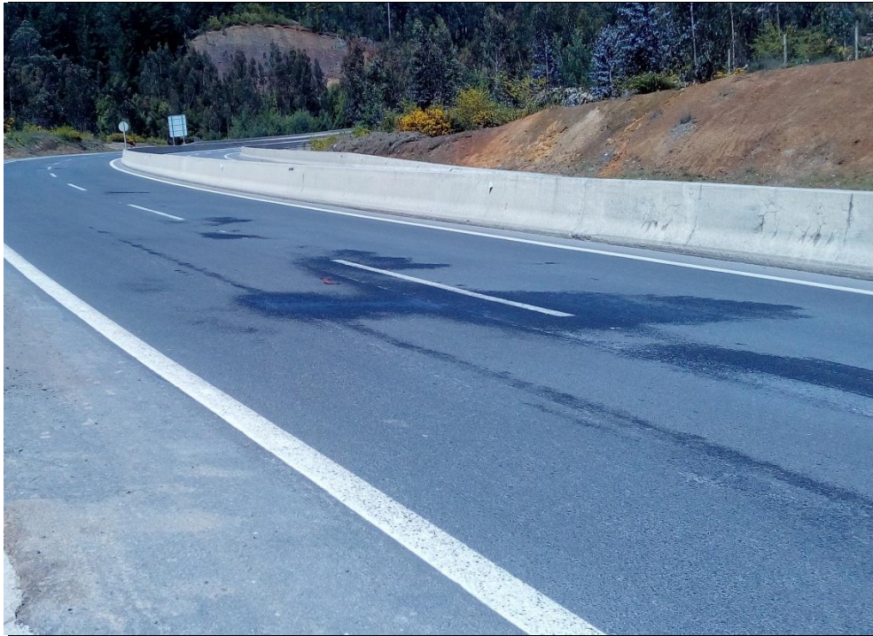
Figura 20: Emanación de agua a través del pavimento de la Ruta CH-160, al pie del talud estudiado.
