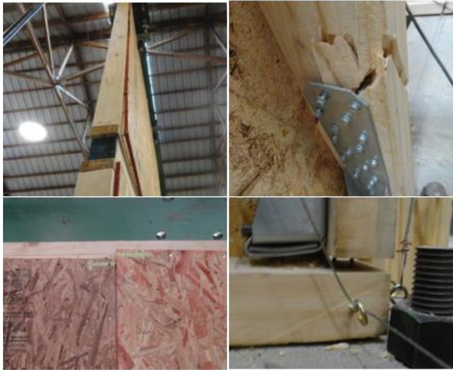
Figura 5.4: Fallas típicas de muros ensayados.
