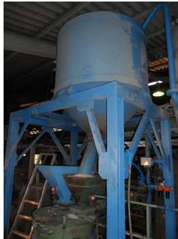
Figura 3.18 Silo de almacenamiento de arena de sílice. (Gure Artea SL, gurearteasl.cl )
