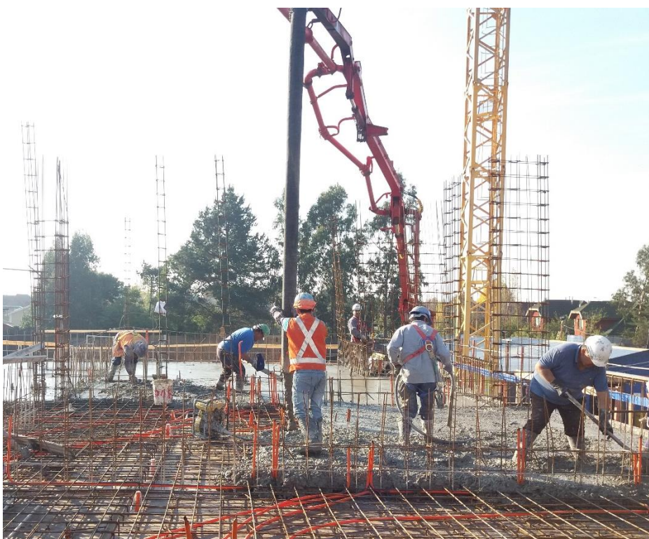
Figura 4.1 Proceso de hormigonado de losas, Torre sur, edificio Nuevo Huertos (Fuente: elaboración propia)
