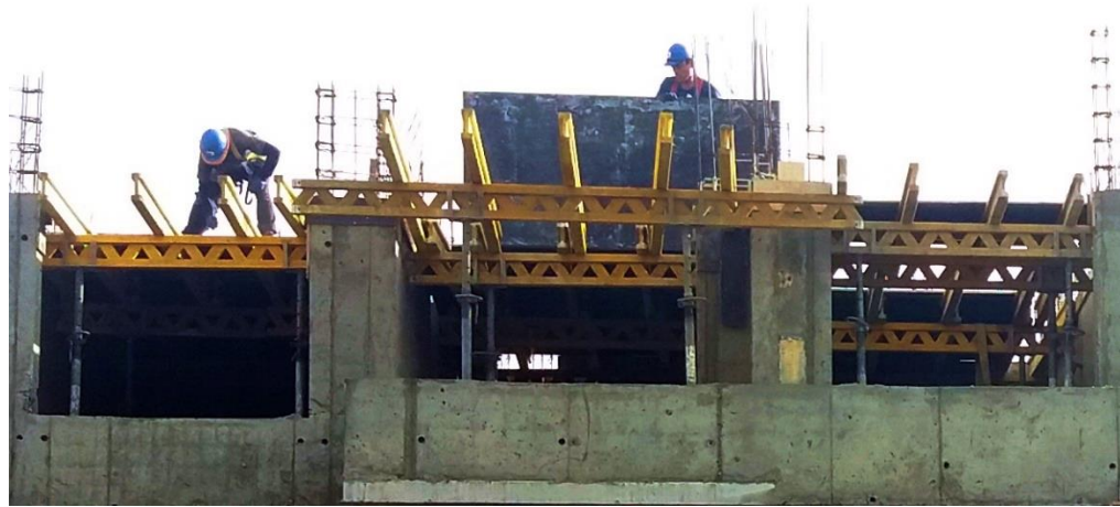
Figura 4.6 Postura de placas fenólicas moldaje de losa, Torre sur, edificio Nuevo Huertos.
