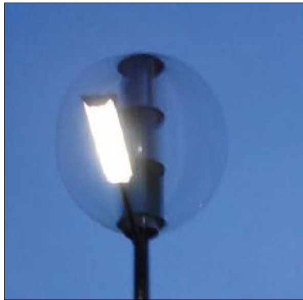
Figura 3. Luminaria encendida del poste.
