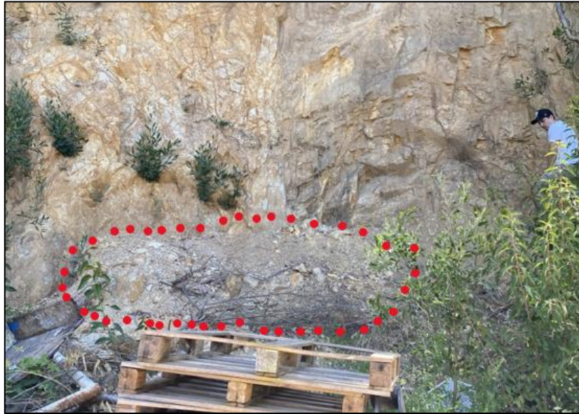
Figura 6: Desprendimiento de material en el punto 3, mostrando en línea punteada material depositado; la vivienda se encuentra a sólo 7 metros de la zona de deposición del material. Imagen tomada en enero del 2023. Elaboración propia.
