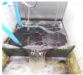
Fotografía 11. Efluente post reubicación de captación de agua de servicio, Frutillar.
