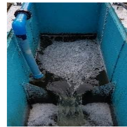
Fotografía 12. Efluente post reubicación de captación de agua de servicio, PTAS Los Lagos.
