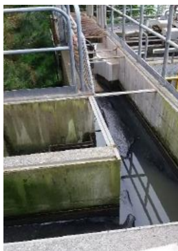
Fotografía 4. Canal acercamiento Parshall de Afluente, PTAS Río Negro.
