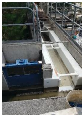
Fotografía 5. Canal acercamiento Parshall de Afluente post extensión y angostamiento, PTAS Río Negro.
