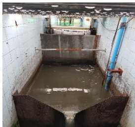
Fotografía 10. Efluente post reubicación de captación de agua de servicio, PTAS Castro.
