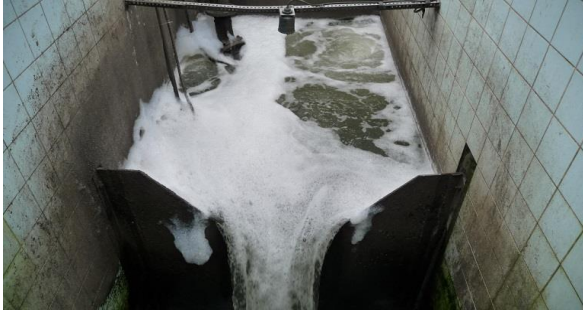
Fotografía 1. Canal de Efluente, PTAS Ancud.
