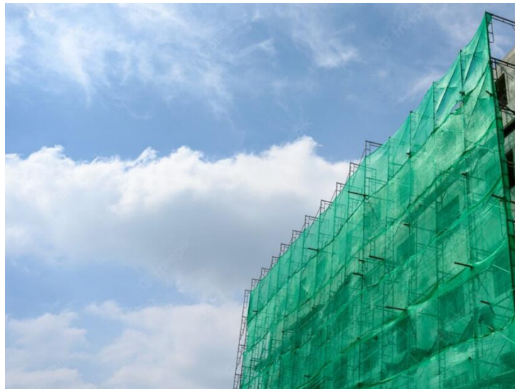
Figura 1. Edificio con andamiaje recubierto de malla Raschel.
