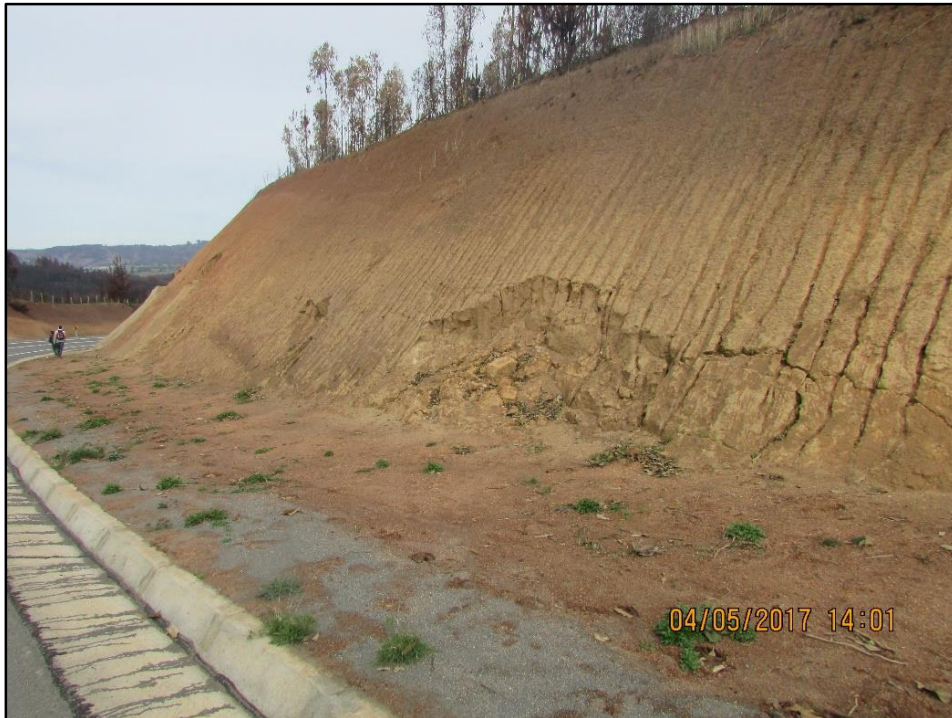
Figura 14. Deslizamiento rotacional en talud de maicillo. Ruta O-390.
