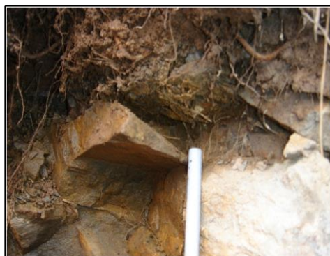
Figura 10. Penetración de raíces en grietas de roca en un talud rocoso, después tras 360 días de su siembra (Xu et al., 2017).
