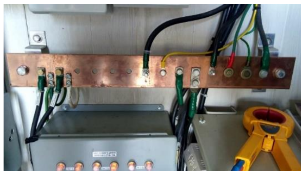
FIGURA 4. 11 Barra principal de tierra de una RBS.
