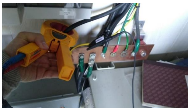
FIGURA 4. 12 Conexión de pinza amperimétrica en el electrodo medido.
