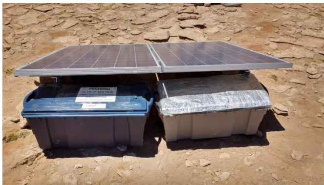
Figura 4-23 A la derecha, caja contenedora del Regulador de Carga.
