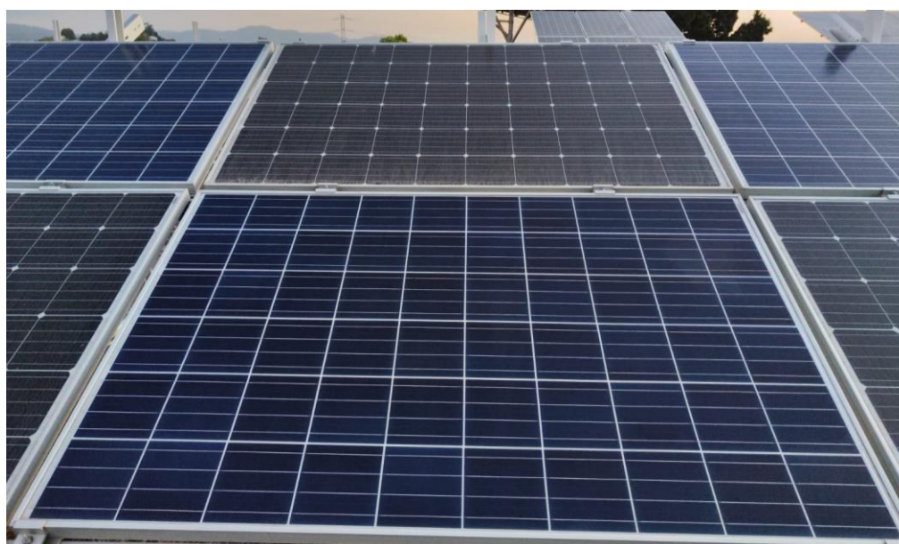
Figura 3.25 Comparación entre un panel limpio y uno sucio por condiciones del entorno
