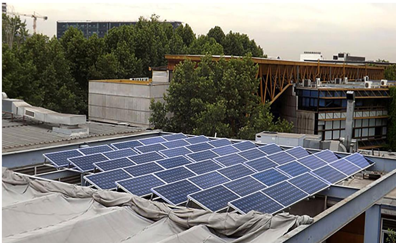
Figura 1.7 instalación fotovoltaica en parte superior de uno de sus edificios.
