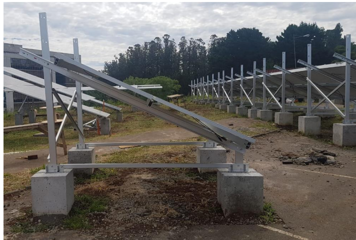
Figura 2.17 estructuras instaladas Monocristalino y Policristalino
