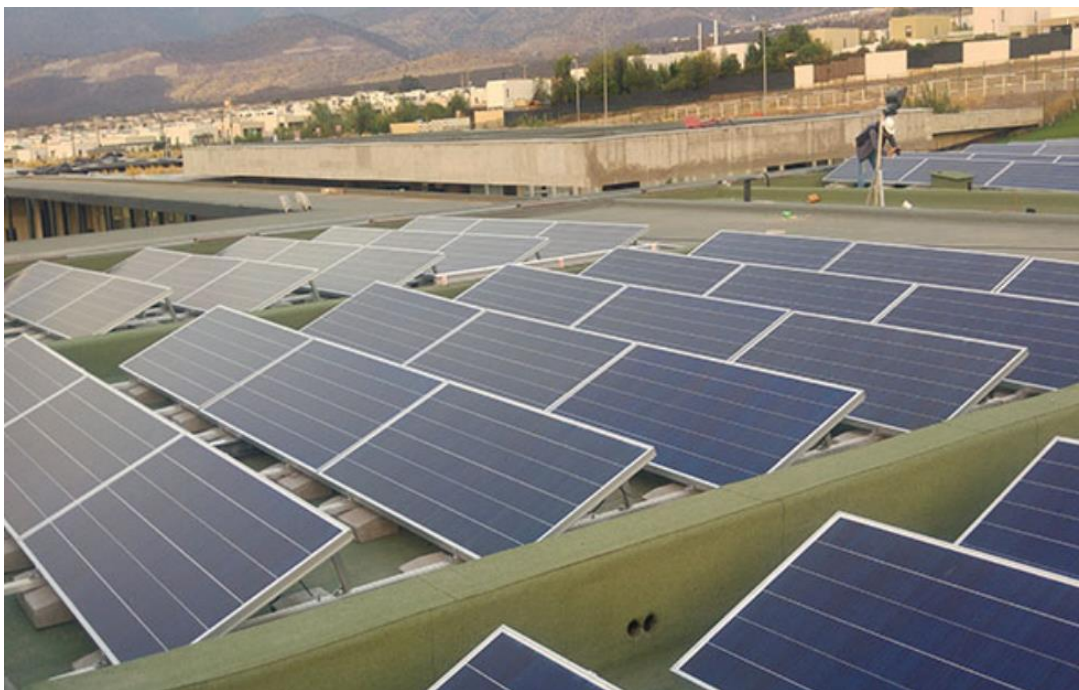
Figura 1.6 Instalación fotovoltaica del tipo TRI-STAND Aero 20°, Colegio Alianza francesa Chamisero
