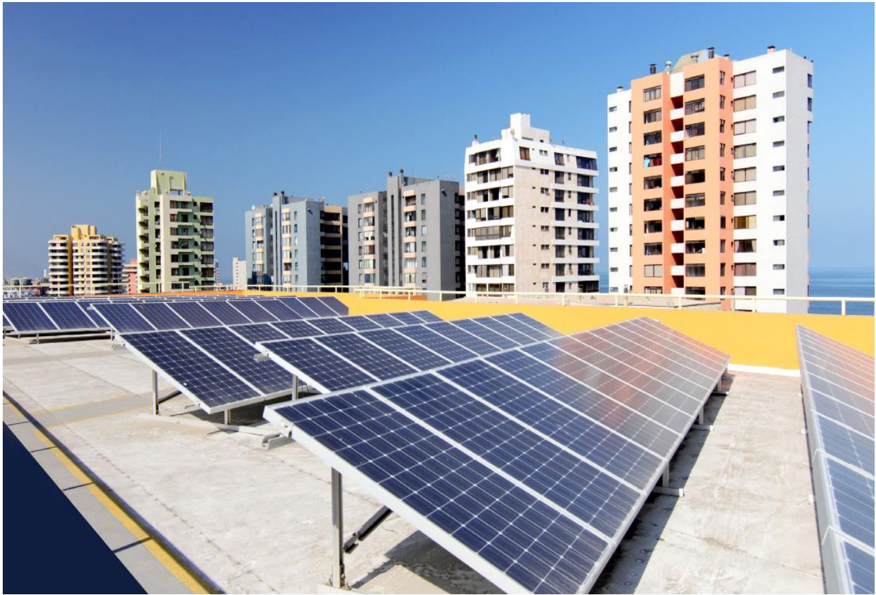
Figura 1.8 Instalaciones en parte superior de edificio, Universidad Antofagasta.
