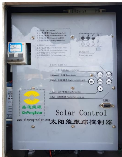
Figura 3.4 Display para control de seguidor Solar de 2 ejes
