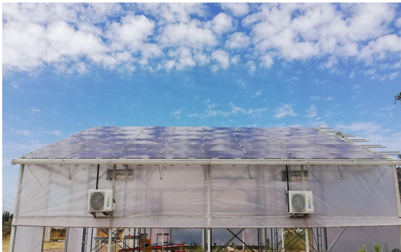
Figura 1.9 Instalación sobre techo de invernadero- Universidad de O’Higgins
