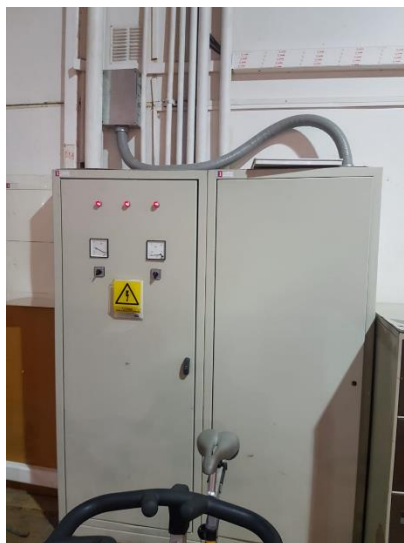
Figura 2.6 Tablero en gimnasio vista exterior
