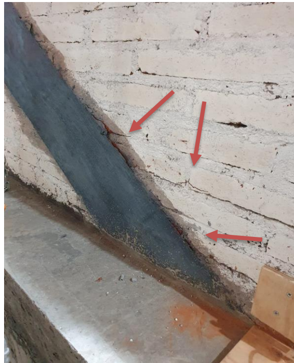
Figura 20: Acercamiento a la grieta y desprendimiento en extremo de refuerzo de CFRP (Fuente: Elaboración propia)
