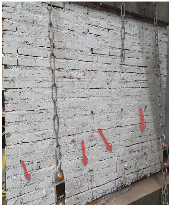
Figura 24: Múltiples grietas en la parte posterior del muro de albañilería (Fuente: Elaboración propia)
