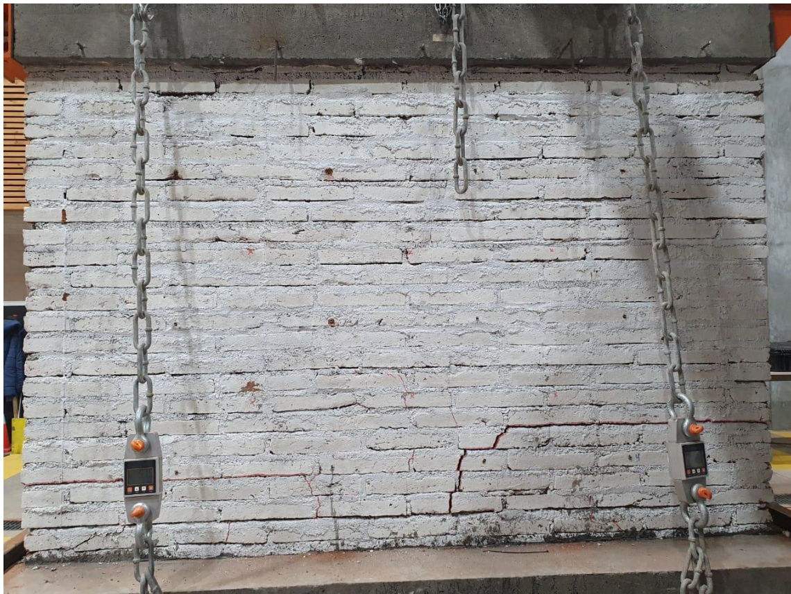
Figura 39: Grietas de la parte posterior del muro no reforzado (Fuente: Elaboración propia)
