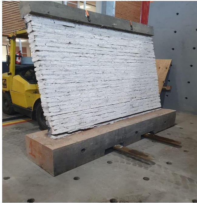
Figura 8: Colapso del muro de albañilería reforzado, producto de su traslado (Fuente: Elaboración propia)
