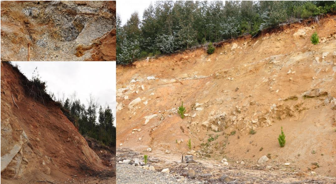
Figura 4.39 Detalle fallas locales talud Camino 9 Fundo El Encanto
