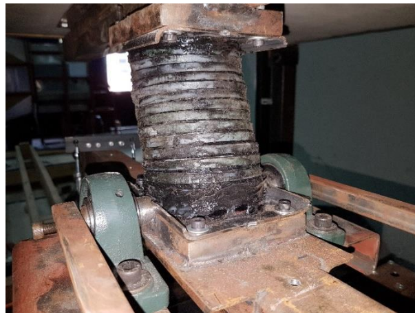
Figura 15: Desprendimiento de aislador a soporte inferior para la condición de empotramiento de 100%.
