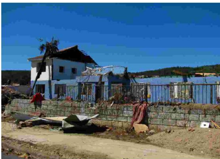
Figura 1.2: Vivienda de albañilería afectada por el paso del tsunami en Dichato. Fuente: SERNAGEOMIN.
