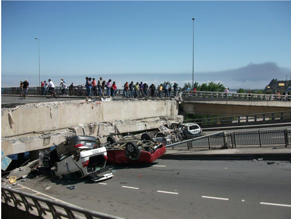
Figura 2.7: Colapso puente Llacolén. Fuente: Panoramio.
