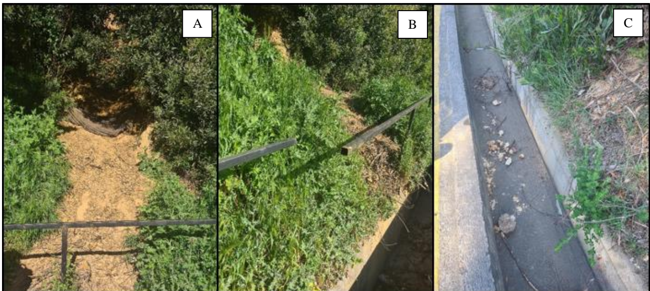
Figura 7: Registro de movimiento en masa anterior en Talud 10. A) Malla instalada por pobladores. B) Barrera rota. C) Material depositado en la zanja a los pies del talud. Elaboración propia (2022).
