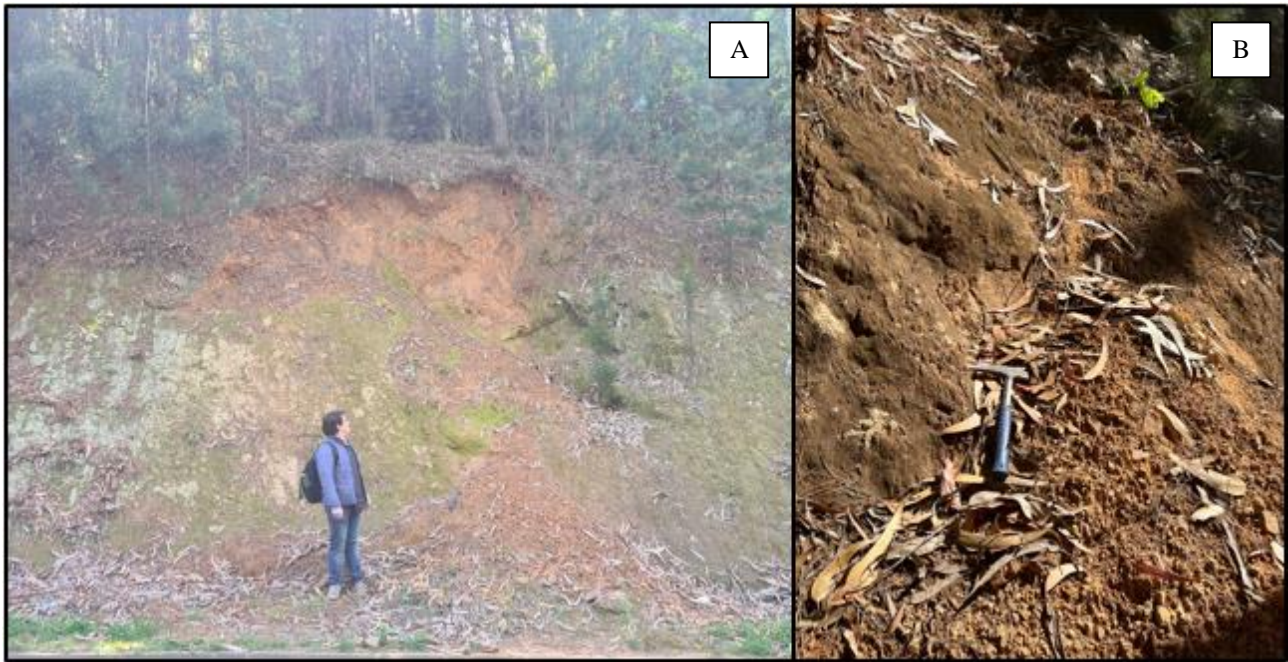
Figura 4: A) Talud 1 con evidencia de movimiento. B) Movimiento en masa anterior en Talud 1. Elaboración propia (2022).
