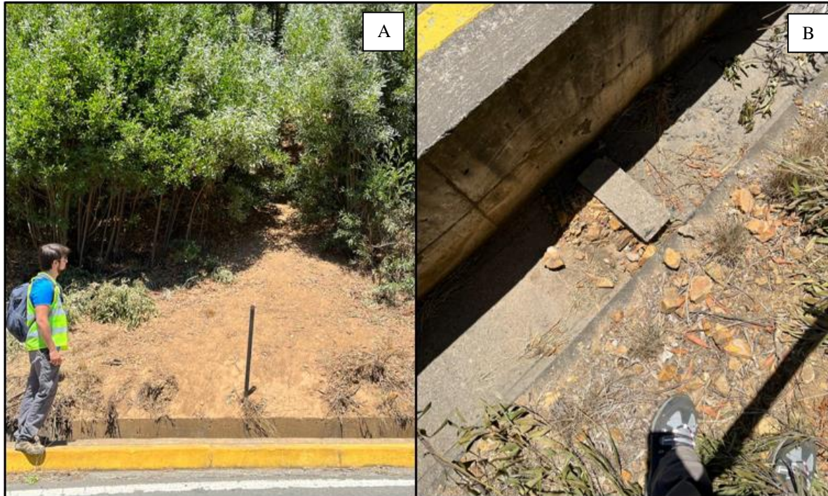
Figura 6: A) Evidencia de movimiento en masa anterior en Talud 8. B) Material depositado en la zanja a los pies del Talud 8. Elaboración propia (2022).
