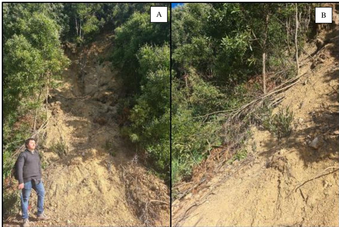
Figura 5: A) Evidencia de movimiento en masa anterior en Talud 7. B) Caída de árboles en talud ocasionado por un movimiento anterior en el Talud 7. Elaboración propia (2022).
