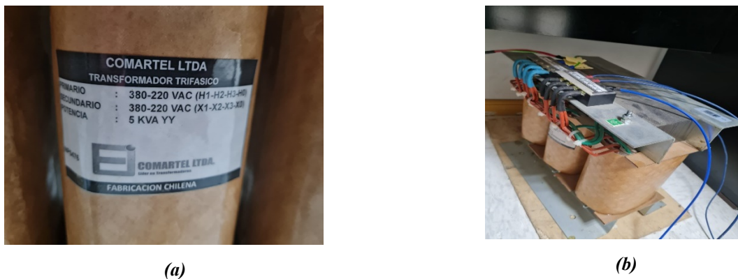
Fig. 41 “Transformador de aislación implementado”
