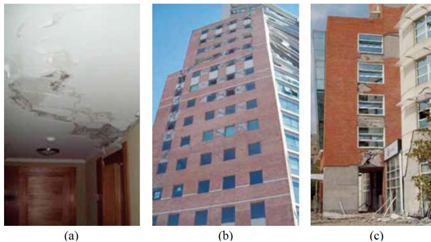
Figura 2.4: Losa de acople y falla por corte Fuente: Informe “Efectos y Enseñanzas del Terremoto 27F de 2010”.
