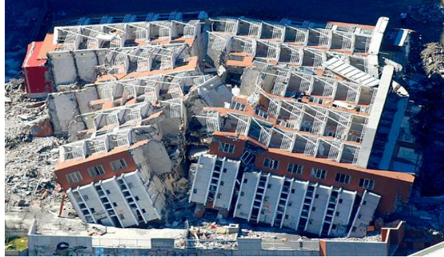
Figura 2.2: Edificio Alto Río Colapsado post Terremoto 27F
