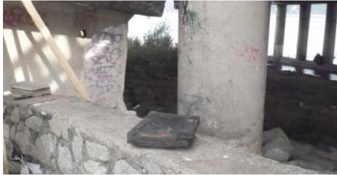
Figura 2.10: Desprendimiento de apoyos de neopreno. (Fuente: [8]).
