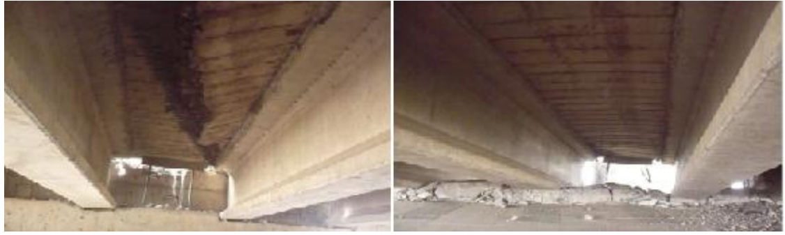
Figura 2.8: Colapso de vigas longitudinales en tramo del puente Llacolén. (Fuente: [8]).
