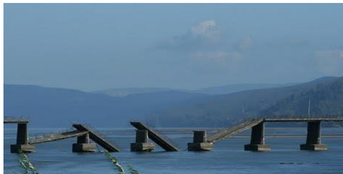
Figura 2.12: Estado Puente Viejo Concepción, Chile terremoto 2010. (Fuente: [1]).
