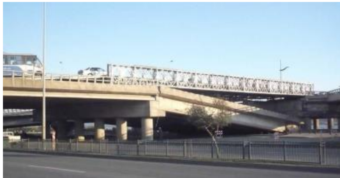
Figura 2.7: Desprendimiento Tablero puente Llacolén, implementación de puente mecano. (Fuente: [8])
