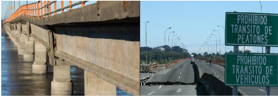
Figura 2.11: Inclinación del Tablero producto del asentamiento en pilas por PSS, Terremoto 2010 Chile. (Fuente: [8]).
