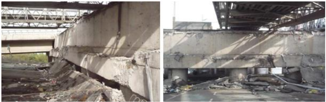
Figura 2.9: Daños en el Tablero y cepa debido al colapso de vigas longitudinales. (Fuente: [8]).
