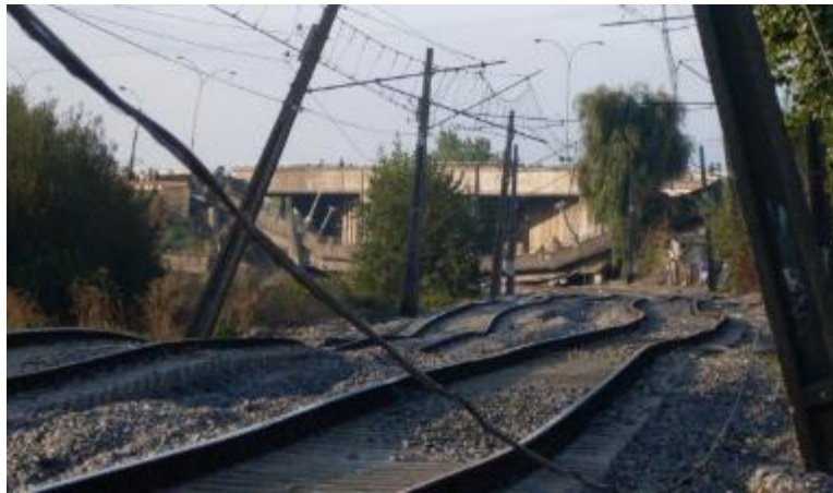
Figura 2.31: Línea férrea en Concepción, después del terremoto del Maule 2010
