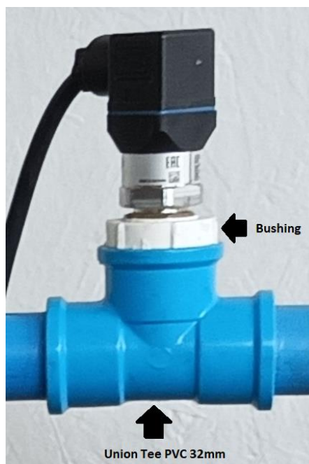
Fig. 3-4. Sensor de Presión WIKA modelo A-10 instalado en el SBFV.
