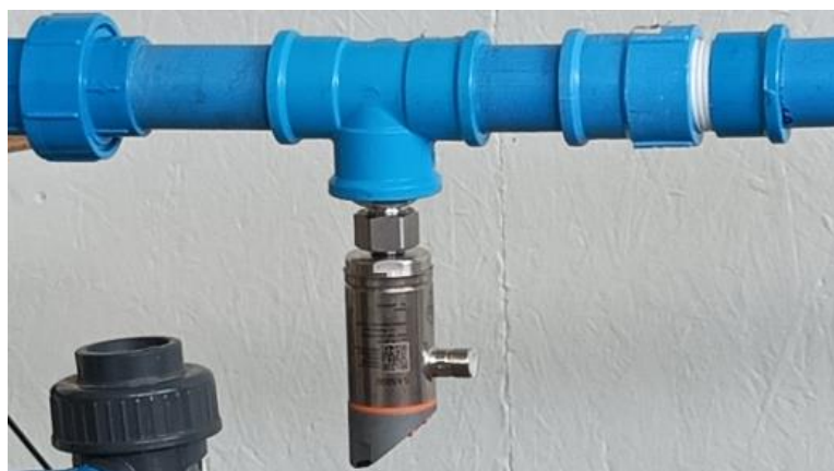
Fig. 3-10. Sensor IFM SA5000 acoplado al SBFV.
