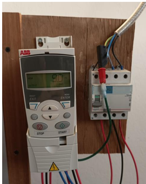
Fig. 2-4. Sistema de control de potencia utilizado en el proyecto (Izquierda: inversor; Derecha: Diferencial que actúa como interruptor).
