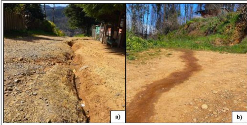
Figura 11: a) Surco de erosión hídrica en parte superior de la Ladera Este. b) Escurrimiento de agua constante desde sistema de mangueras instaladas. (Elaboración propia).
