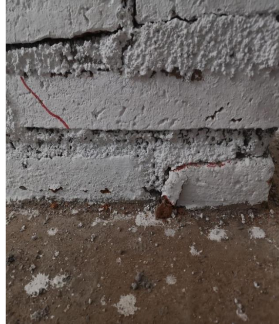
Figura 27: Unión de grietas anteriores y desprendimiento de ladrillo en 12 (mm) (Fuente: Elaboración propia).
