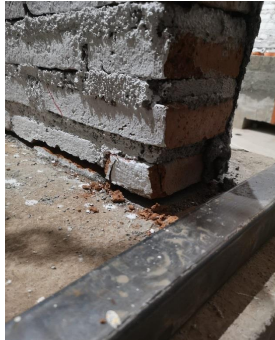
Figura 31: Separación total del cuerpo del muro a los 18 (mm) (Fuente: Elaboración propia).
