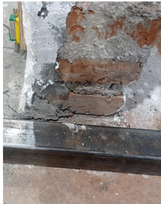
Figura 19: Grieta en junta de la base del muro registrada a los 6 (mm) (Fuente: Elaboración propia).
