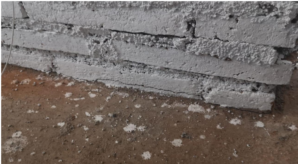
Figura 21: Grieta en junta de la base en extensión a los 6 (mm) (Fuente: Elaboración propia).
