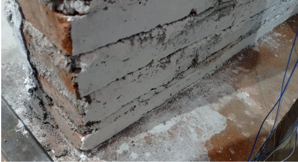
Figura 20: Grieta en junta de la base en contracción a los 6 (mm) (Fuente: Elaboración propia).
