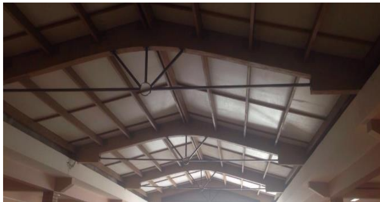
Ilustración 13: Estado real al interior del techo tipo 2. Fuente : Elaboracion propia.
