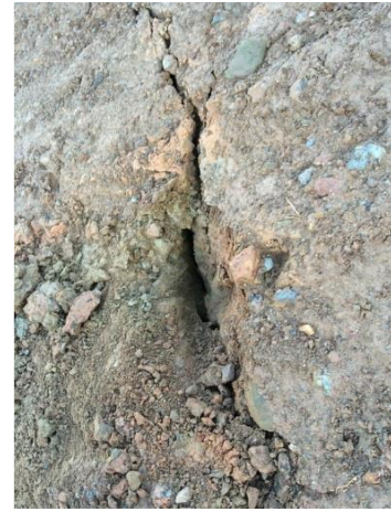
Figura 7.4: Tamaño de grieta en talud. (Fuente: CONCESIONARIA RUTA 160 – Evaluación talud Dm 40+000 – 40+400; Informe Técnico)
