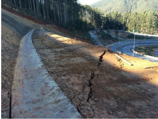
Figura 7.6: Grietas en terraza. (Fuente: CONCESIONARIA RUTA 160 – Evaluación talud Dm 40+000 – 40+400; Informe Técnico).
