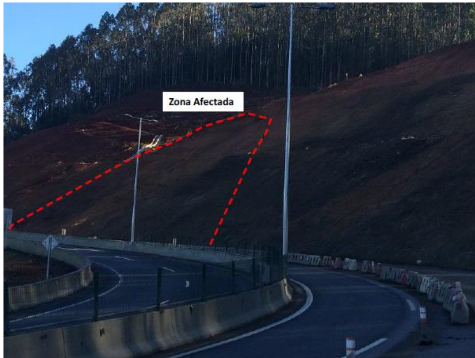
Figura 1.4: Identificación de zona inestable. (Fuente: CONCESIONARIA RUTA 160 – Evaluación talud Dm 40+000 – 40+400; Informe Técnico).
