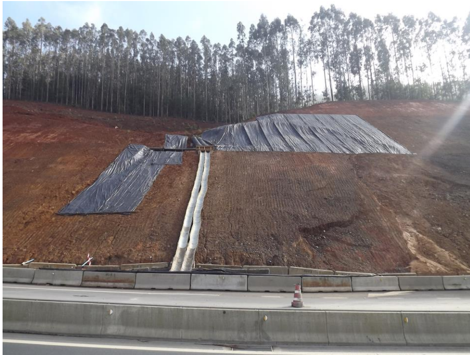
Figura 1.7: Estado actual del talud en Chivilingo - Ruta 160, con fecha 26-12-2016 (Fuente: Elaboración propia).
