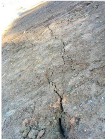
Figura 7.3: Zona del talud agrietada. (Fuente: CONCESIONARIA RUTA 160 – Evaluación talud Dm 40+000 – 40+400; Informe Técnico)
