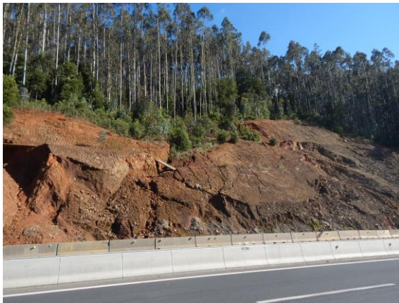
Figura 7.1: Colapso de talud ubicado en Chivilingo, toma frontal (fuente: Elaboración propia)
