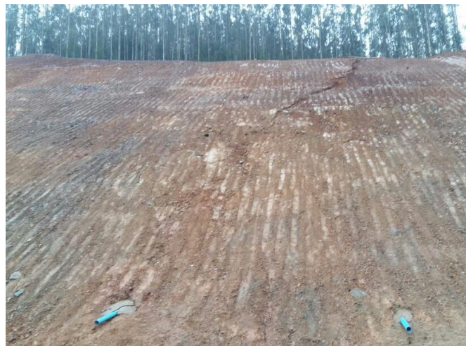
Figura 7.5: Prolongación grietas hacia el talud y deslizamientos menores. (Fuente: CONCESIONARIA RUTA 160 – Evaluación talud Dm 40+000 – 40+400; Informe Técnico)
