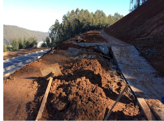
Figura 7.7: Ruptura badén. (Fuente: CONCESIONARIA RUTA 160 – Evaluación talud Dm 40+000 – 40+400; Informe Técnico).
