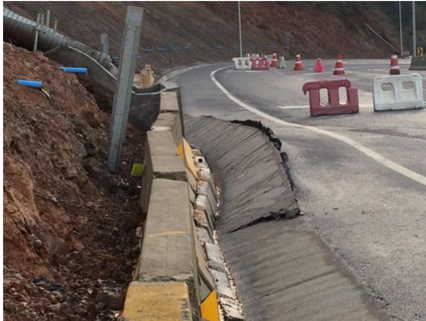
Figura 1.6: Rotura de cuneta, berma y deformaciones a nivel de pista de incorporación dirección norte-sur. Julio de 2016. (Fuente: CONCESIONARIA RUTA 160 – Evaluación talud Dm 40+000 – 40+400; Informe Técnico).
