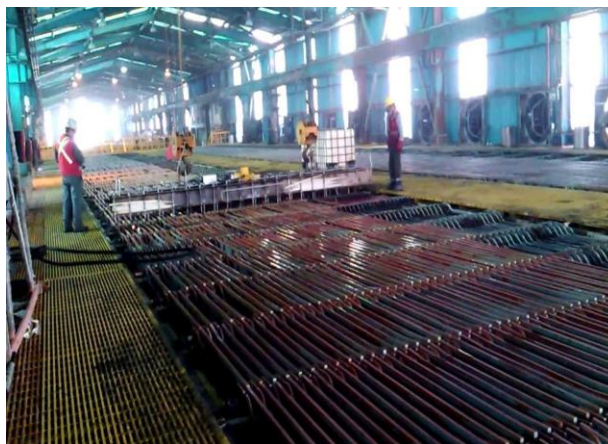
Fig. 2-2: Nave de Electroobtencion Anglo American.
