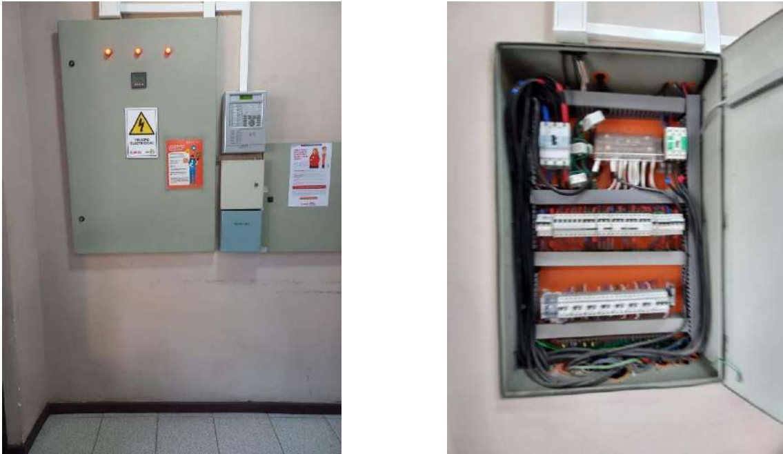
Fig. 4.17 Tablero General Facultad de Medicina.
