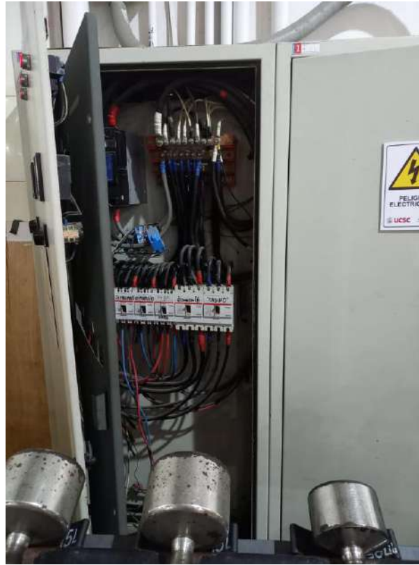
Fig. 4.33 Tablero General Obstruido.
