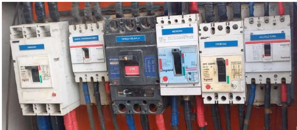
Fig. 4.10 Tablero General 1 (Derecho).
