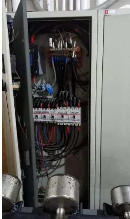
Fig. 5.43 Tablero a Intervenir
