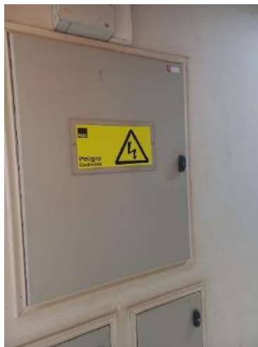
Fig. 4.23 Tablero General Acuicultura.
