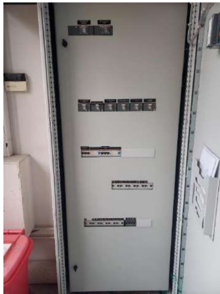
Fig. 4.15 Tablero General Facultad de Ciencias.
