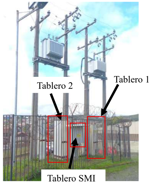
Fig. 4.9 Subestación Eléctrica Lomas de San Andrés.
