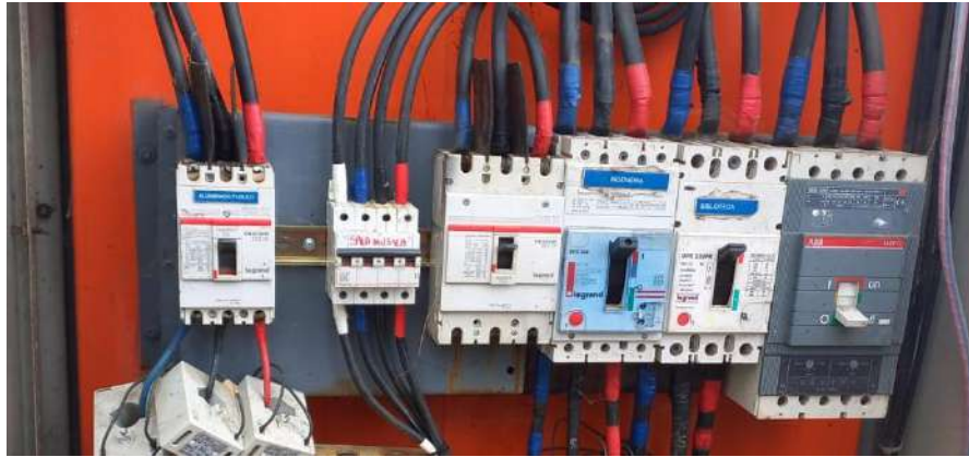
Fig. 4.11 Tablero General 2 (Izquierdo).
