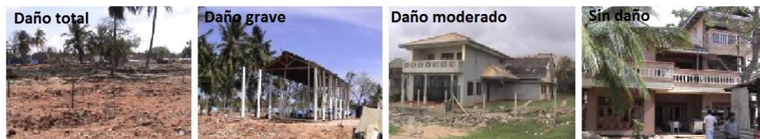
Figura 2.10: Niveles de daño mediante encuestas de campo (Murao).
