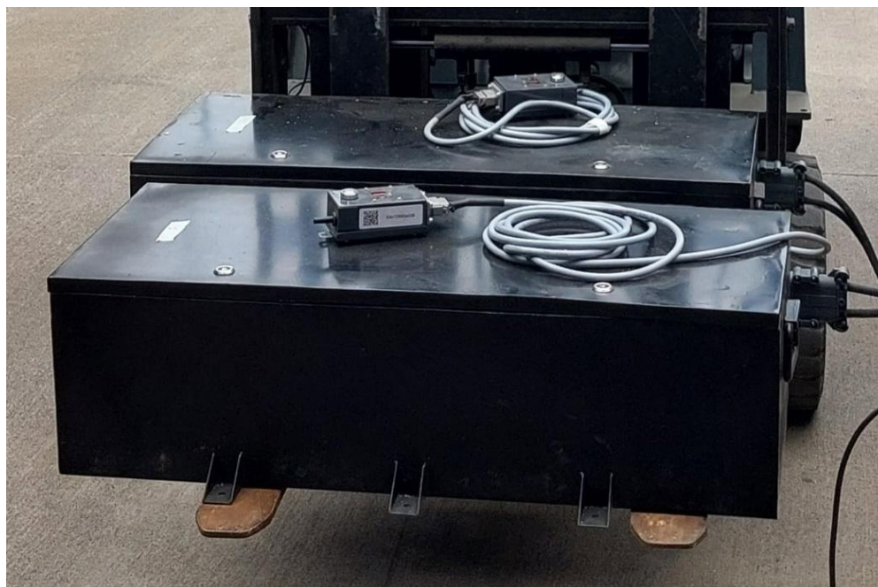
Fig. 3.4 Baterías de litio 1 y 2.
