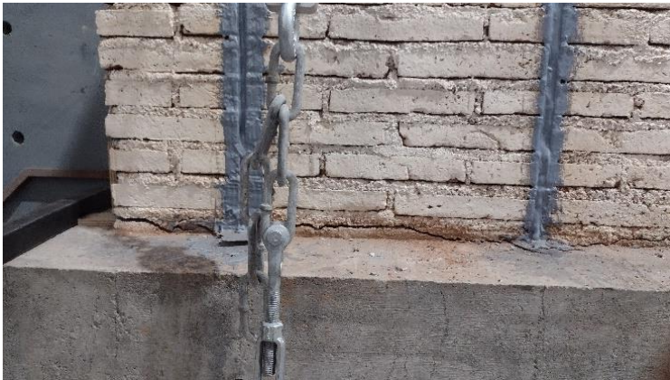
Figura 12: Falla por deslizamiento en la base del muro por sobre la fundación
