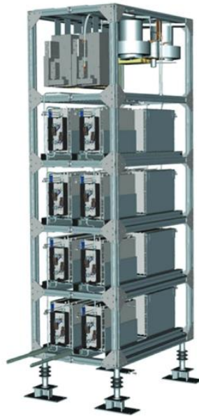
Fig. 2.13 SVC PLUS instalado en Alemania [13]
