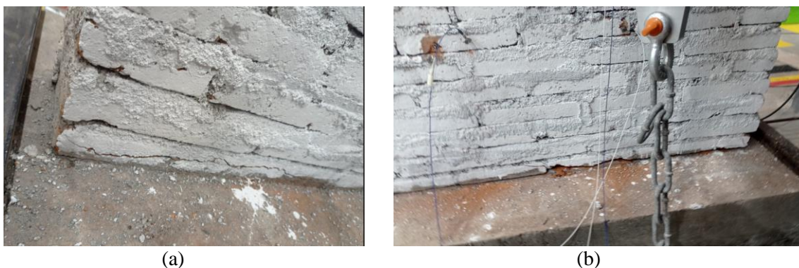
Figura 9: (a) aparición de grietas en los ladrillos parte inferior izquierda, (b) falla por adherencia junta muro/fundación parte inferior derecha. (Fuente: elaboración propia).
