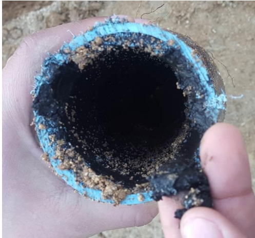
Figura 11 Tubería antes de limpieza con capa de 7 mm de sarro.
