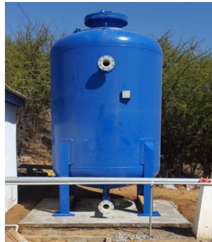
Figura 10 Filtro Floculador instalado en Sauzal.
