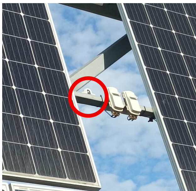
Fig. 5.3. Sensor de irradiancia en seguidor solar de doble eje.
