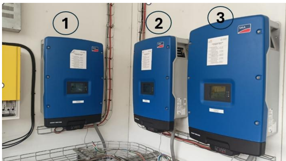
Fig. 3.11. Inversores SUNNY TRIPOWER ubicados en laboratorio Microred.
