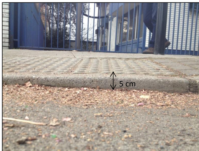
Figura 6-25: Rebaje peatonal con cota mayor de 3 cm. Intersección Chacabuco/Aníbal Pinto, sector 3.
