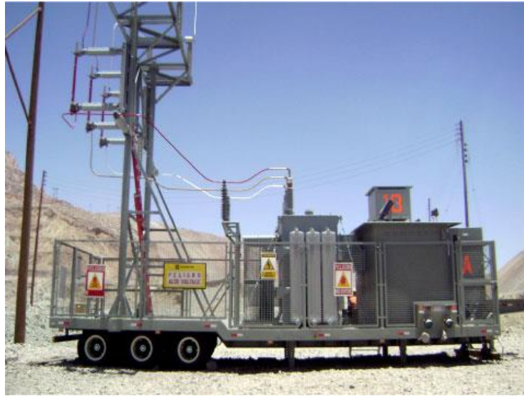
Fig. 6-2 Ejemplo Subestación Móvil
