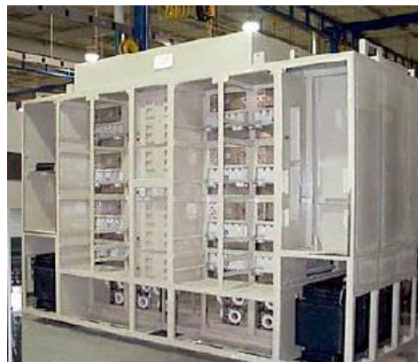
Fig. 8-11 Gabinete de potencia de Convertidores
