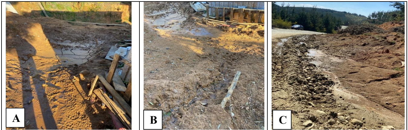
Figura 15: En las dos primeras imágenes (A y B) se observa la zona de estudio del punto 1, la cual muestra una sobresaturación visible en la superficie. En la tercera imagen (C), el punto 3 también se encuentra sobresaturada en el pie del talud, ya que, tras la remoción, las áreas de drenaje han quedado bloqueadas. Elaboración propia.
