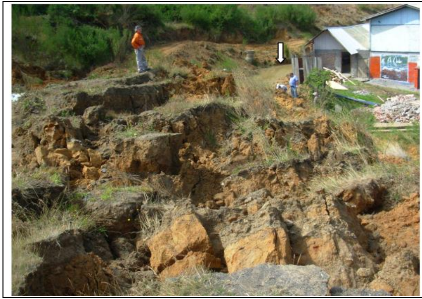
Figura 4: Se produjo un deslizamiento desde un cerro formado por acopio de material estéril, obstruyendo el canal que pasa por detrás de calle Alameda (Ramírez & Derch, 2010).
