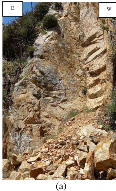
Figura 19: Corresponde a las ubicaciones de las estaciones geomecánicas. (a) EGS7 con coordenada UTM 18H//662850/ 5930421.
